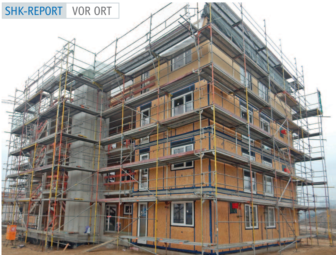
Bild 1: Das Mehrfamilienhaus des umBau 2 Turley e.V. in Mannheim entsteht in Holzständerbauweise mit dem energieeffizienten freeAir-Lüftungssystem von bluMartin. Das Foto zeigt die Einbausituation der Rohbausets der Lüftungsgeräte vor dem Anbringen der Außendämmung. Gut zu sehen sind der luftdichte Anschluss an die OSB-Platten und die roten „Mützen“ der Platzhalter für die Außenhauben.
